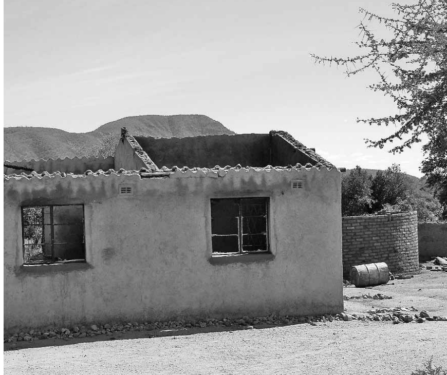
Ausgebranntes und ausgeweidetes Haus in Chipinge. Foto: Barbara Müller
